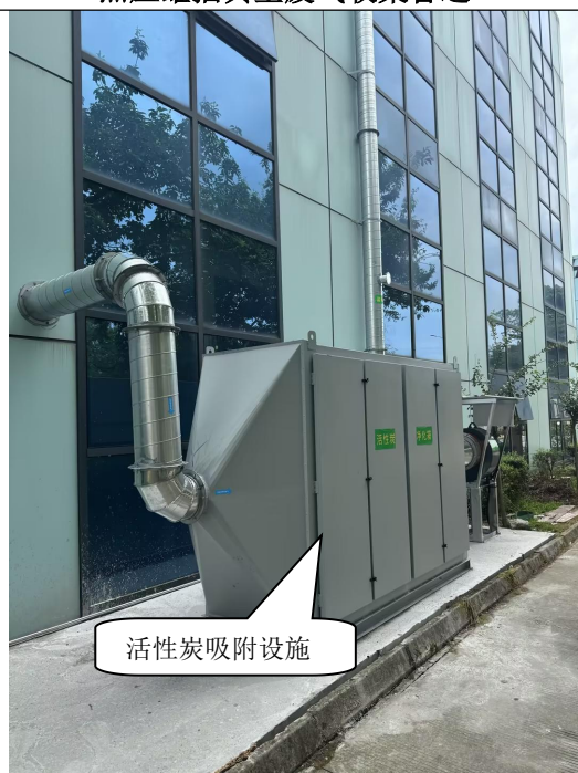
检验室废气处理设施（活性炭吸附）
