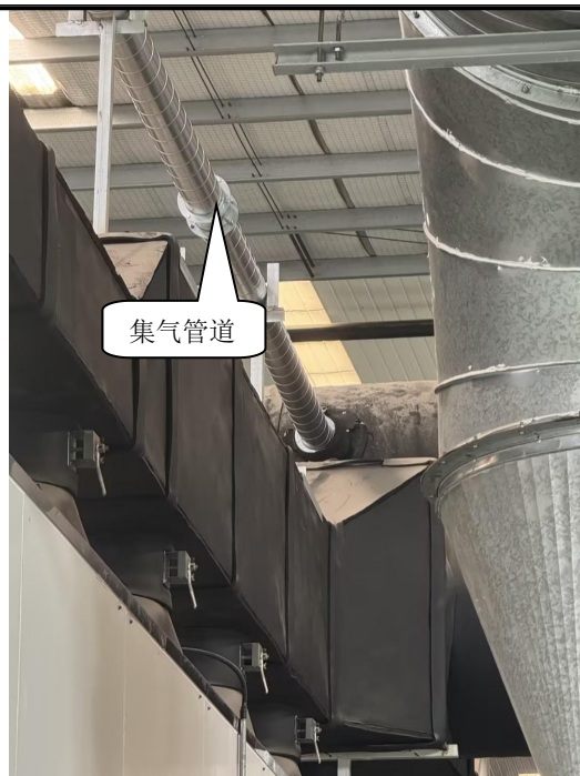
热压罐抽真空废气收集管道 2
