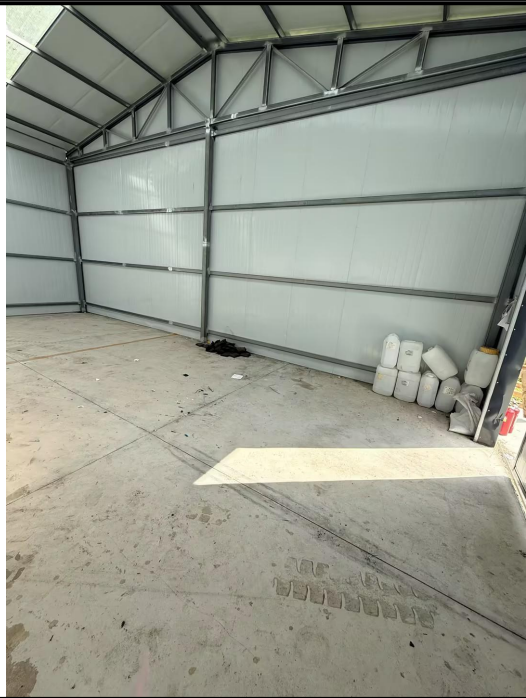
一般固废间内部
