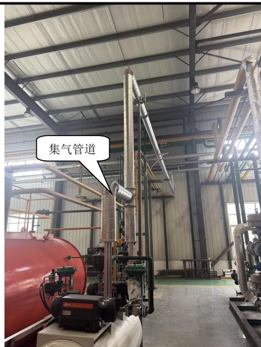
热压罐抽真空废气收集管道 1
